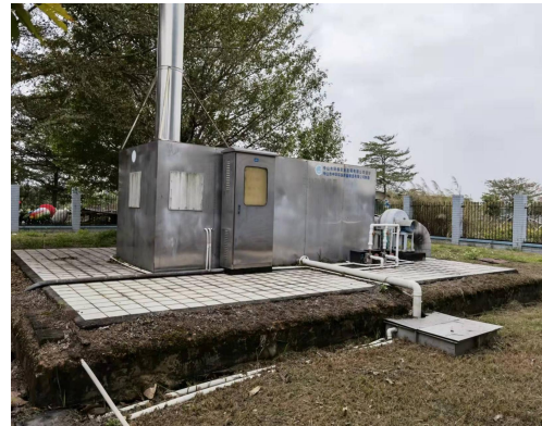
图 2.3.1-11 生物除臭设备
